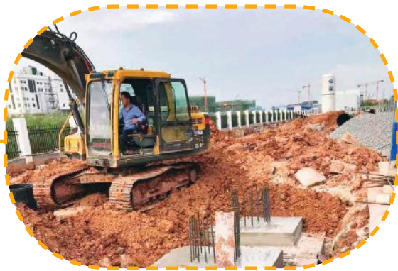
瑞声科技南宁产业园光学模组发展项目新建饭堂基础承台施工完成
